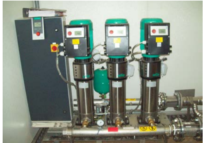
Drukverhogingsinstallatie Kamp Castor, Mali 2015.
