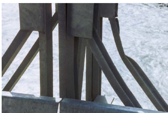
Een beschadigde M&J
