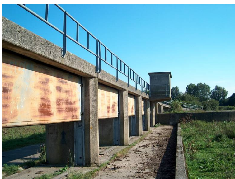
4.15. Locatie 8. Doorlaatsluis met stalen schuiven, 2005. (Herkomst: SB4 .)
